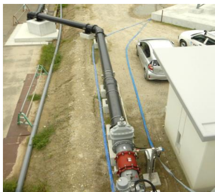
▲黒色の配管を通して工業用水が運ばれてきます。
