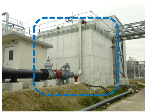
▲運ばれた水は工水受水槽という貯水の建物に一時的に溜められます。
